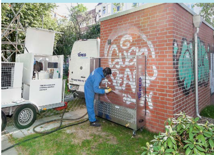
Eine Trafostation in Hamburg ist mit Farbschmierereien überzogen. Der Auftraggeber wünscht eine Komplettreinigung und vorbeugende Maßnahmen zum besseren Schutz gegen erneute Farbschmierereien.
