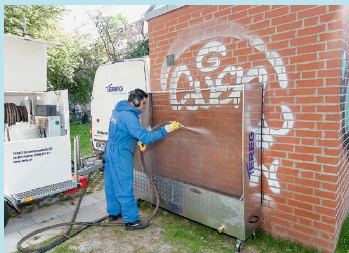
Mittel der Wahl bei der Entfernung ist ein Feuchtsandstrahlverfahren – ohne Zusatz von Chemie. Welches Strahlgut zum Einsatz kommt, ist abhängig von der Oberfläche und deren Verschmutzungsgrad.
